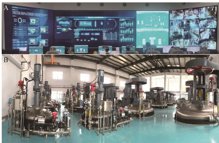
图2 浙江仙居君业药业有限公司甾体核心原料生产中央控制室 (A) 及车间 (B)
